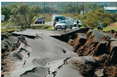
Εικόνα 16.2: Καταστροφή από σεισμό
